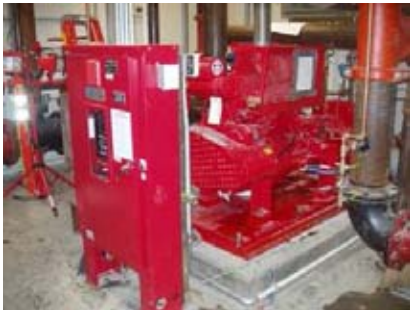
Bomba contra incendio
