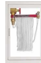
Red de Hidrantes Interiores
